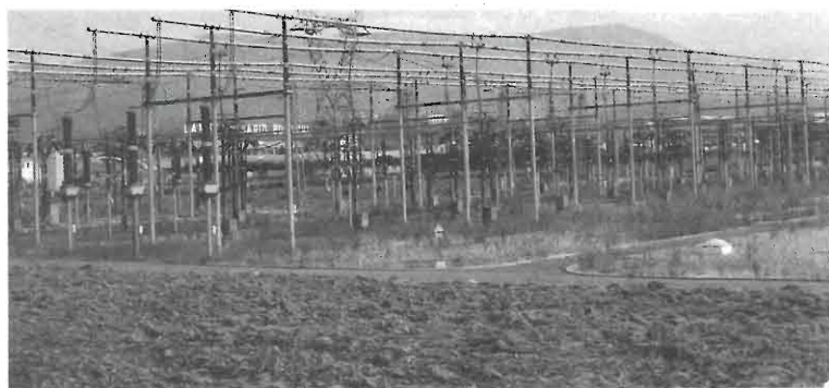
Sbarre alta tensione 380kV con sezionatori a braccio robot (Prato).
