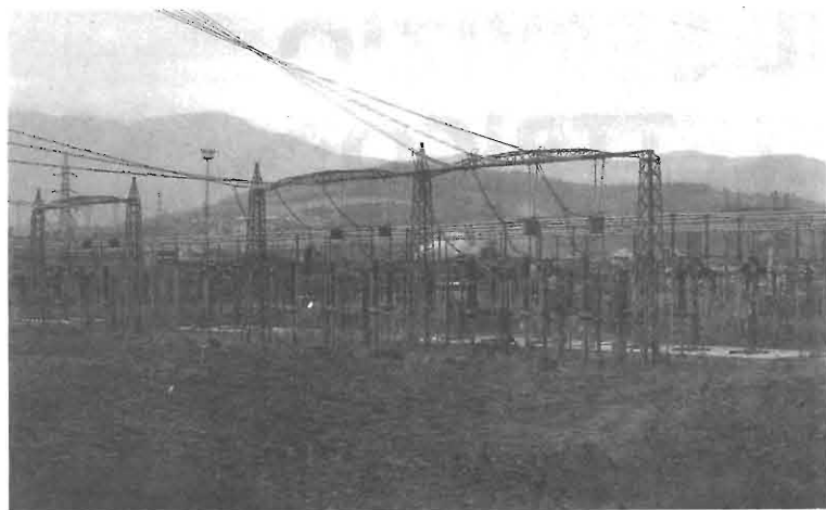
Stazione 380kV (Prato).
