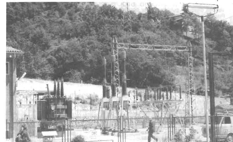
Piccola sottostazione per trazione FS (Vado). Particolare interruttori e trasformatore in olio.
